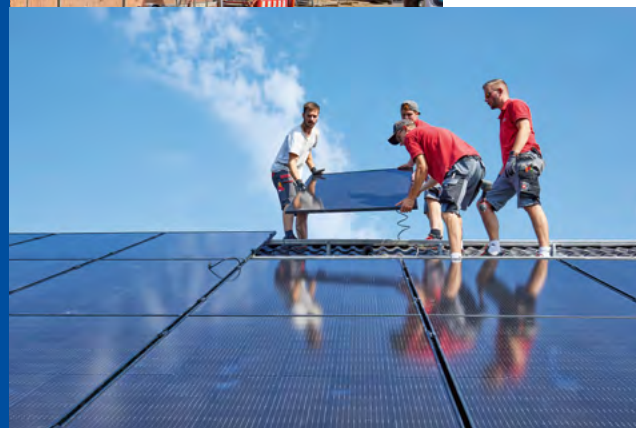
Für die ökologischen Aspekte stehen die mit Photovoltaik eingedeckten Dächer (kleines Foto) und, als echte Neuheit, 23 CO 2 -freie Wohnungen. Soziale Standards werden mit der freiwillig gewählten Quote von 36 Prozent öffentlich geförderter Wohnungen gesetzt. 52 Prozent der Wohnungen bietet die WOGEDO zu preisgedämpften Mieten an. Fertigstellung: im Frühjahr 2024.
