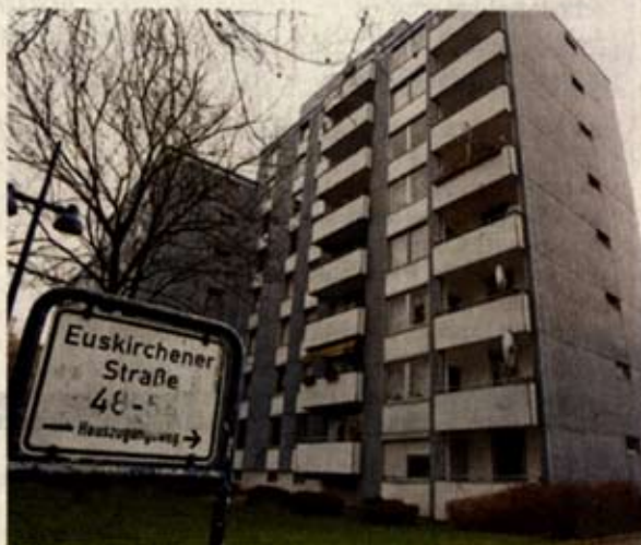
Die Häuser an der Euskirchener Straße in Erfttal: Wegen des Schimmelbefalls mussten schon fünf Familien ausziehen. Fotos: Uli Engers
